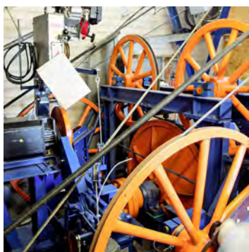
Der Antrieb der Seilbahn stammt von der Firma R. Niederberger & Söhne AG Dallenwil.
